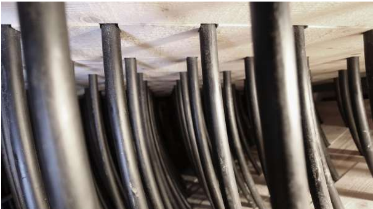
Georg Bechter Die Leitungen werden dafür sorgen, dass das Eis taut, damit Energie zum Heizen entsteht
